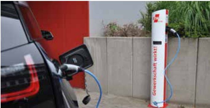
Ständig unter Strom – Gewerkschaft wirkt! Seit dem 1. Juli 2018 steht eine Ladesäule für Elektroautos an der GEW-Landesgeschäftsstelle in Essen. Foto: GEW NRW
